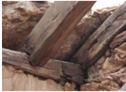
Pormenor de ligação de varas revelando degradação pela presença de humidade
