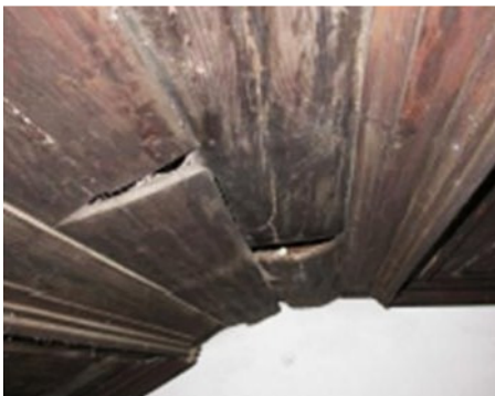
Tábuas em risco de descolamento
