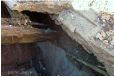
Danos provocados pela presença da água
