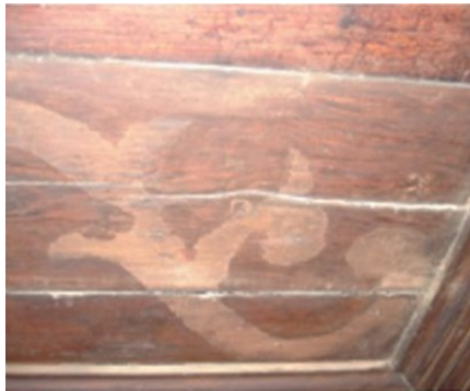
Pormenor de vestígios de elementos decorativos no interior das molduras
