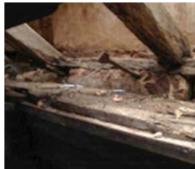
Aspecto geral de mau estado de conservação do frechal
