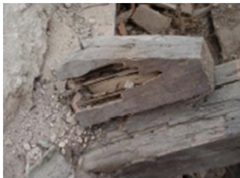
Cunha em madeira com graves danos estruturais
